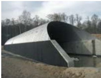
Връзка на стоманена конструкция с бетонен фундамент Connection of a steel structure with concrete footing
